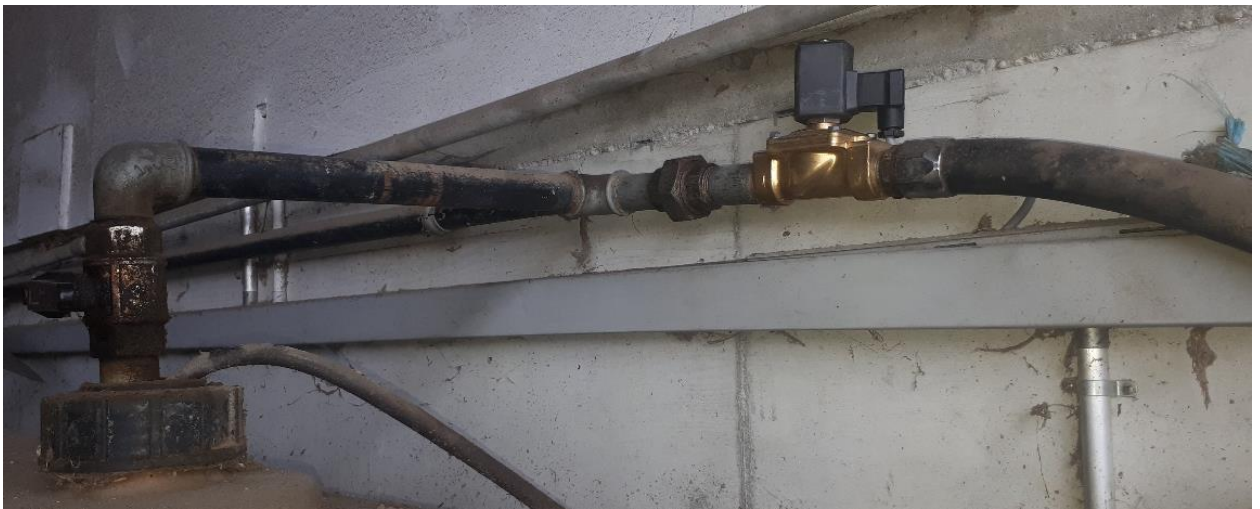
Abbildung 2: Abheberventil einer Betankungsanlage. Dies sichert ein unkontrolliertes Auslaufen des Tankes bei Unfällen.
