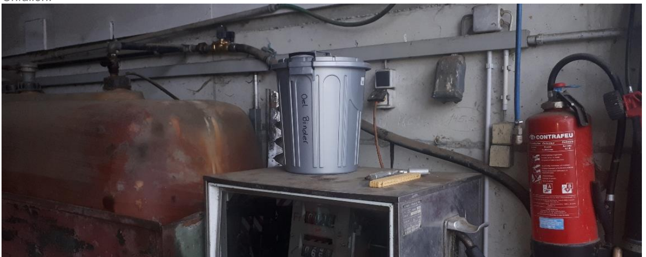
Abbildung 3: Auch ältere Betankungsanlagen können den Gewässerschutzvorschriften genügen, sofern die Vorschriften gemäss Auffangwanne, Binder und Sicherungen gegen das Abhebern erfüllt sind.
